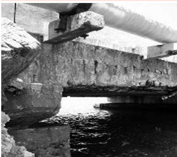
Foto 4: Corrosión generalizada de todos los elementos
